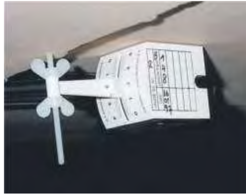
Fisurómetro colocado horizontalmente para medir el hundimiento de una solera.
