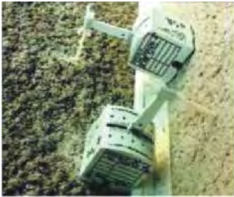
Fisurómetros colocados verticalmente en 2 muros perpendiculares para evaluar una junta de dilatación.
